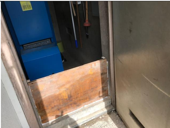
Sichern Heizung gegen Sand
